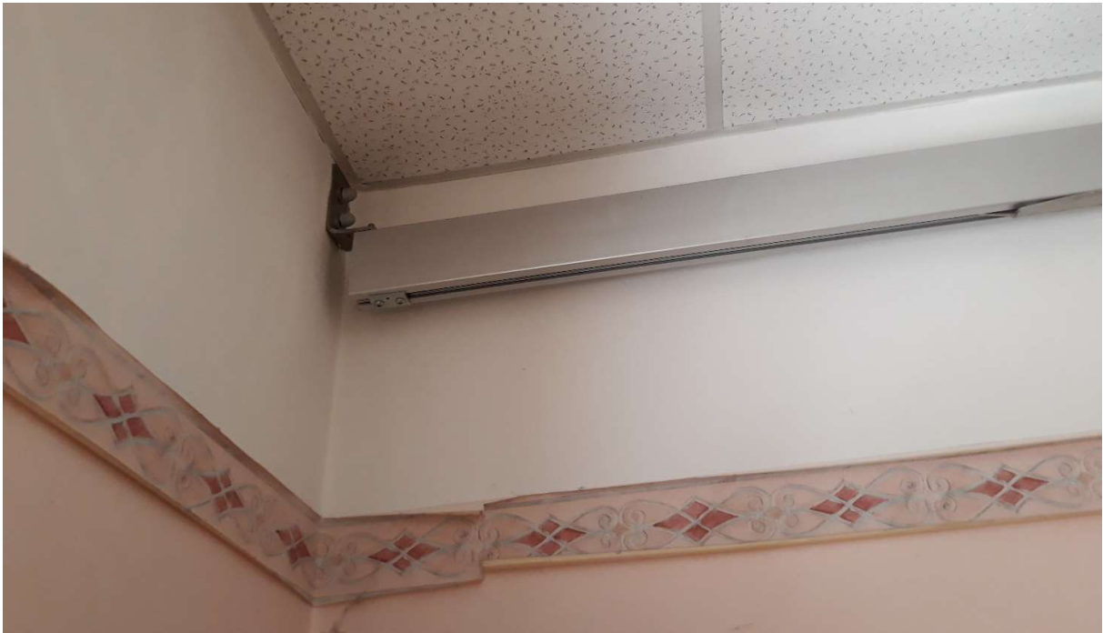
Foto 37 – Le Magnolie – Stanza B8 – esempio di installazione
