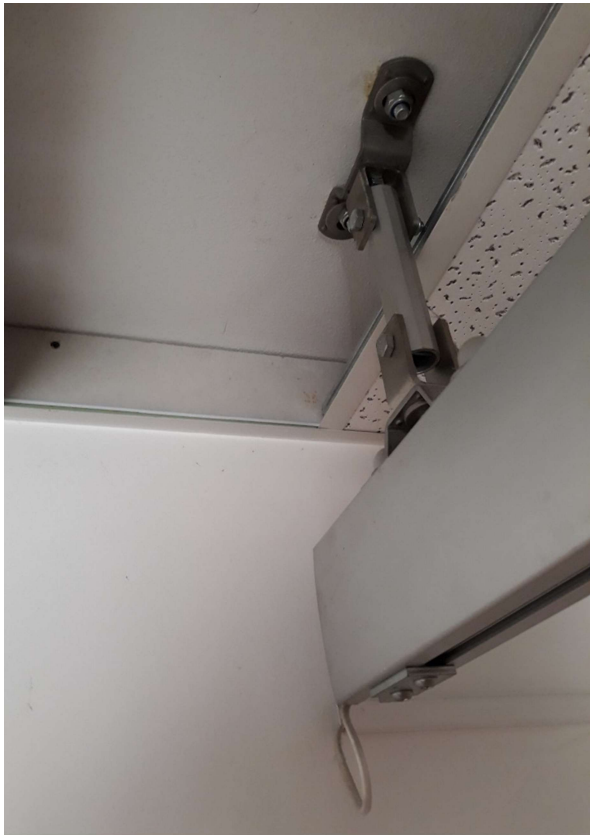
Foto 39 – Le Magnolie – Stanza B8 – esempio di installazione
