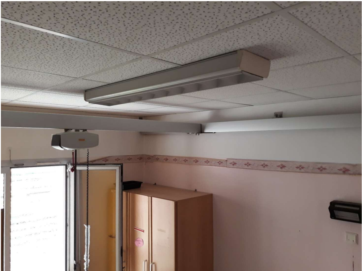
Foto 38 – Le Magnolie – Stanza B8 – esempio di installazione
