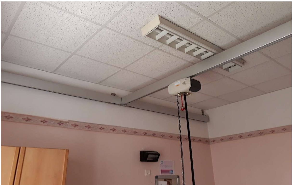
Foto 36 – Le Magnolie – Stanza B8 – esempio di installazione
