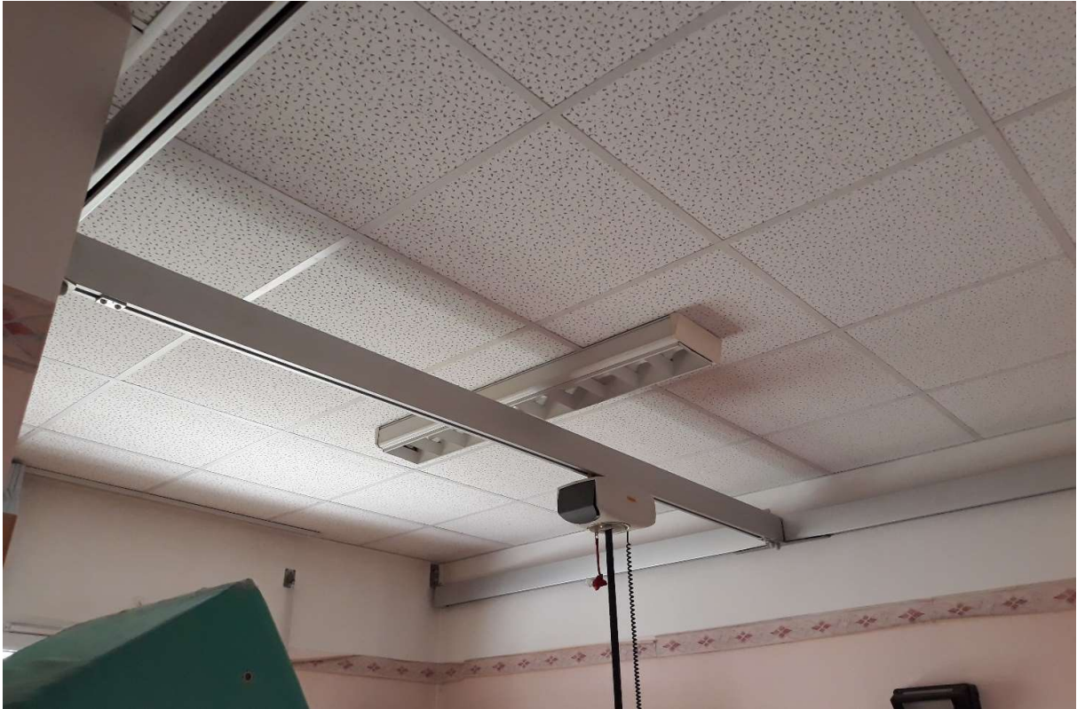
Foto 35 – Le Magnolie – Stanza B8 – esempio di installazione
