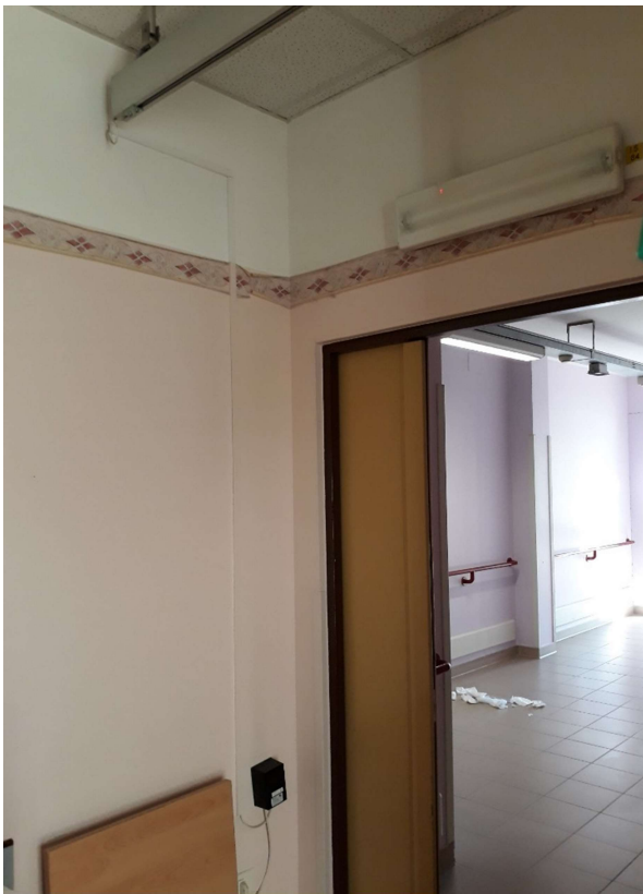
Foto 40 – Le Magnolie – Stanza B8 – esempio di installazione
