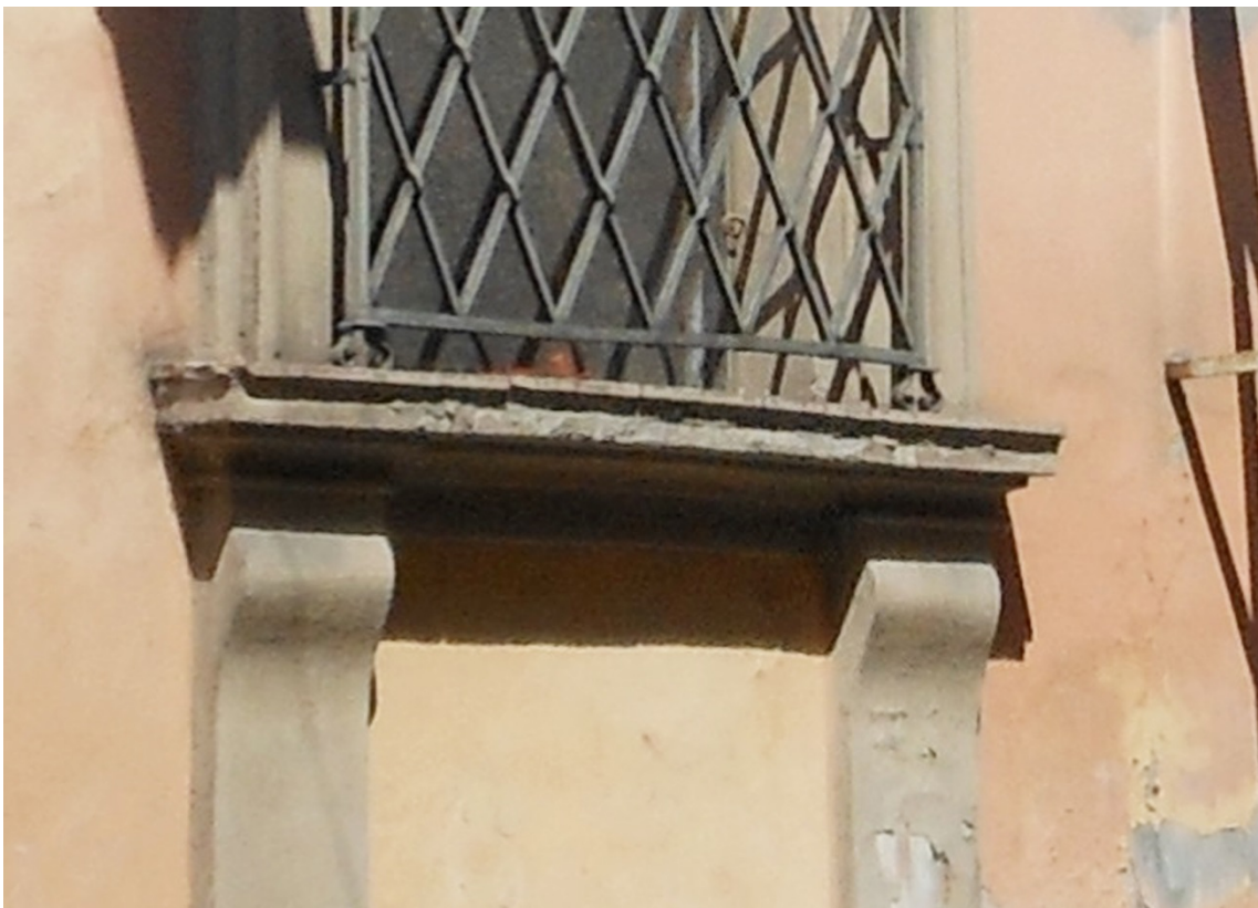
Rigonfiamento del davanzale delle finestre del piano terra
