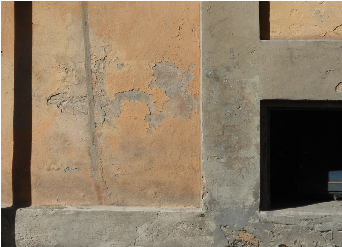
Esfoliazione dovuta alla risalita di umidità
