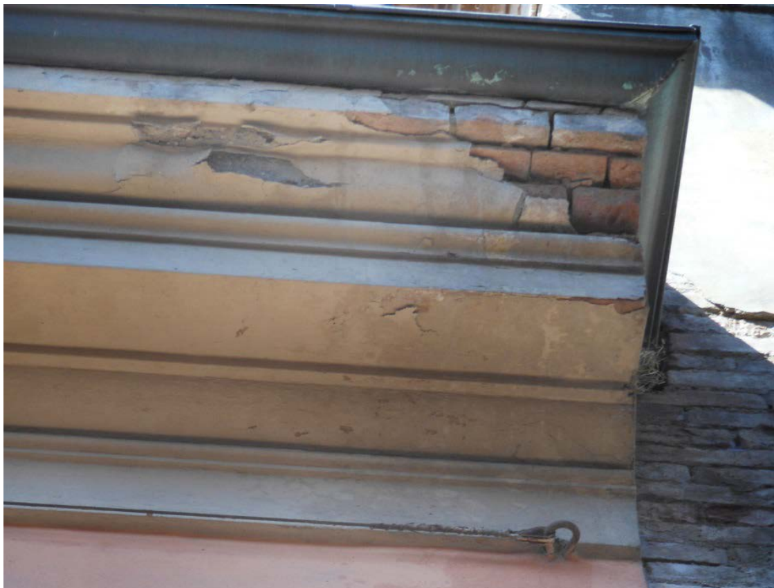
Dilavamento nell'angolo destro sotto al cornicione
