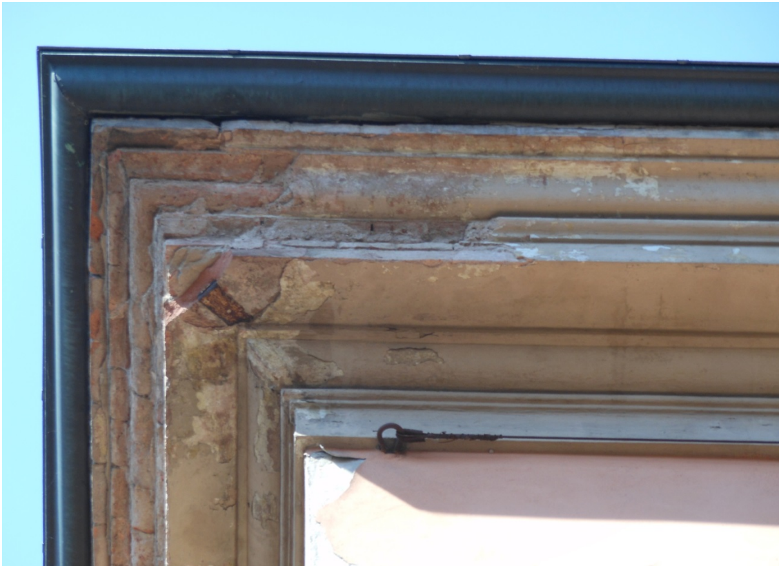
Degrado dell'angolo sinistro del cornicione
