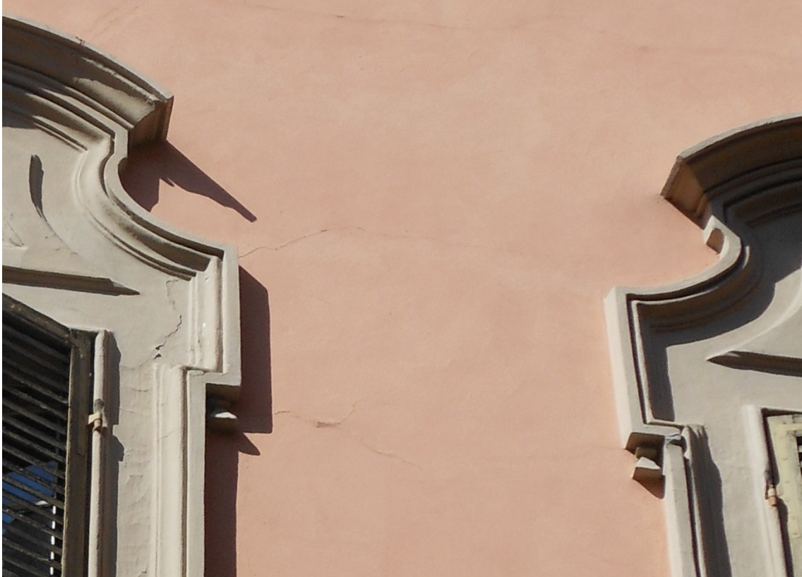
Lesioni tra le aperture del piano superiore
