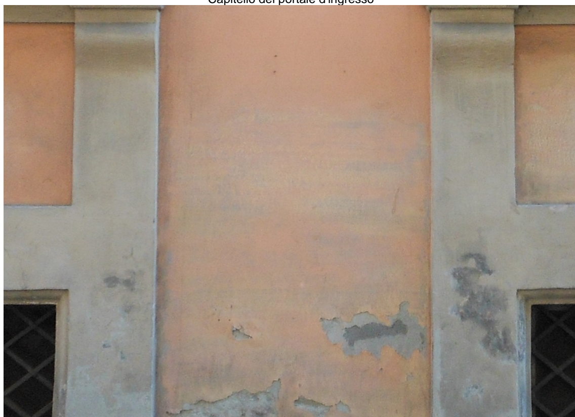
Variazione cromatica dell'intonaco al piano terra
