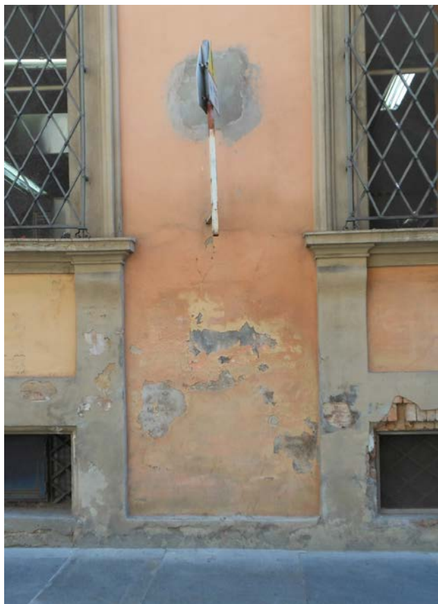
Integrazione con malta incongrua e macchie di umidità
